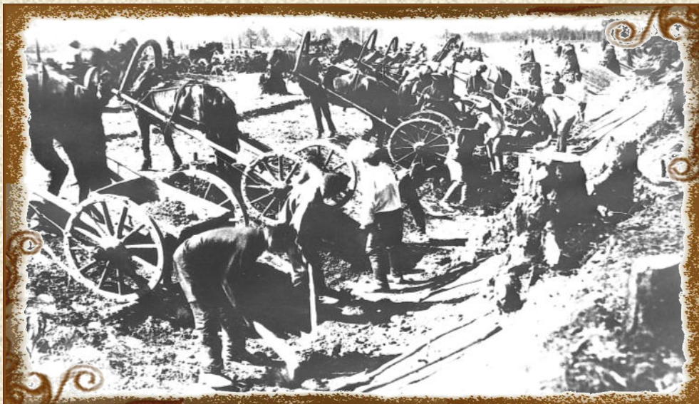
Строительство диатомитового комбината. ГКУСО «ГА в г. Ирбите». Ф. Р-1039. Оп. 1. Д. 18. Л. 11.
